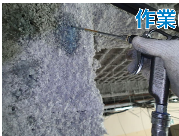
半湿式石綿（注入飛散防止）
